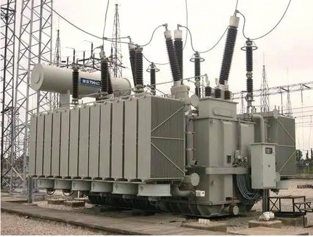
Resim 1: Transformatörün Dışarıdan Görünüşü
